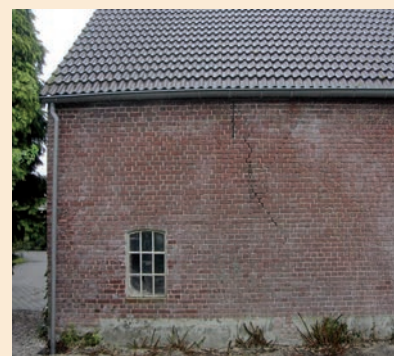
Scheurvorming als gevolg van funderingsprobleem
