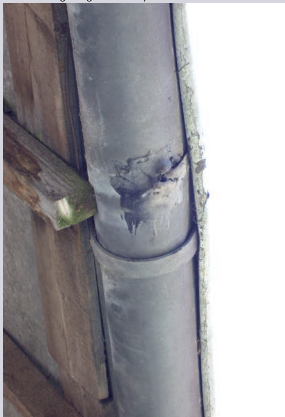
Ondeskundige uitgevoerde reparatie
